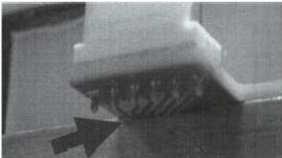
Изображение: късо съединение на пътя на проводника поради твърде малка вдлъбнатина в подпората
