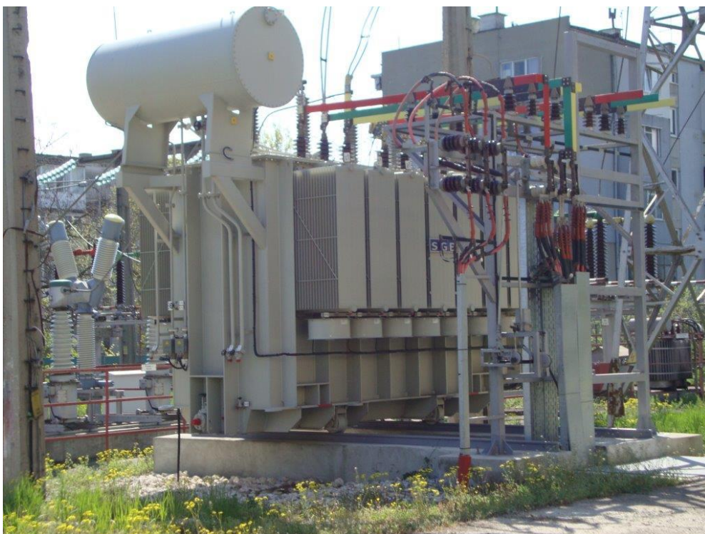
Снимка 2: 110 kV секция
