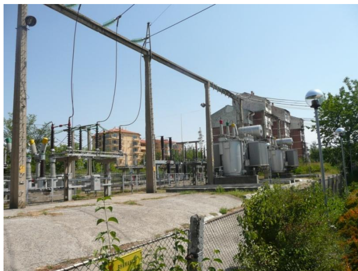
Снимка 8: Подстанция „Велико Търново”
