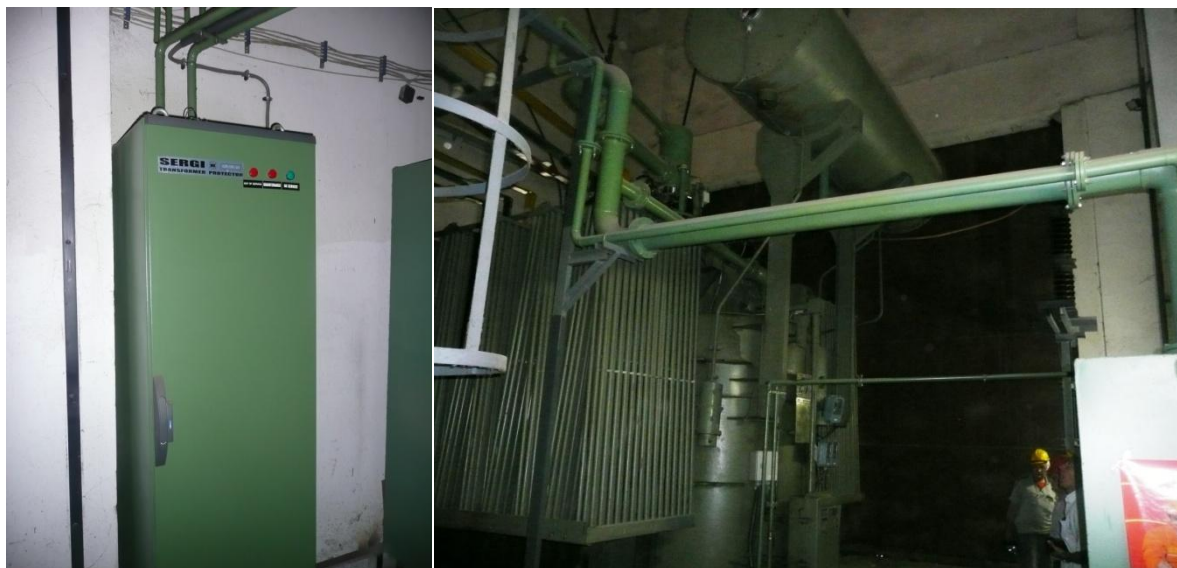
Снимка 14: Пожарогасителна система Sergi
