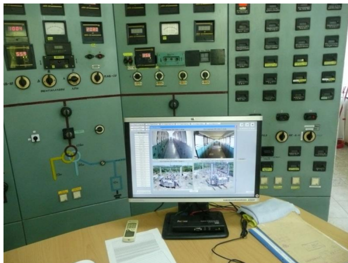
Снимка 9: Локален контролен панел
