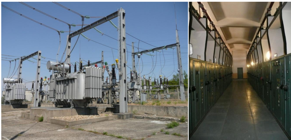
Снимка 5: Част 110 kV и част 10 kV
